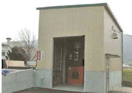
木質バイオマスボイラー室
