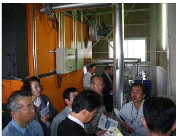
木質ボイラの様子
