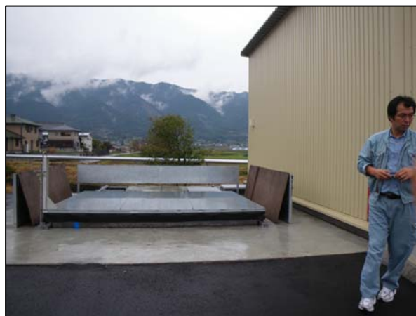
木質チップ投入口
