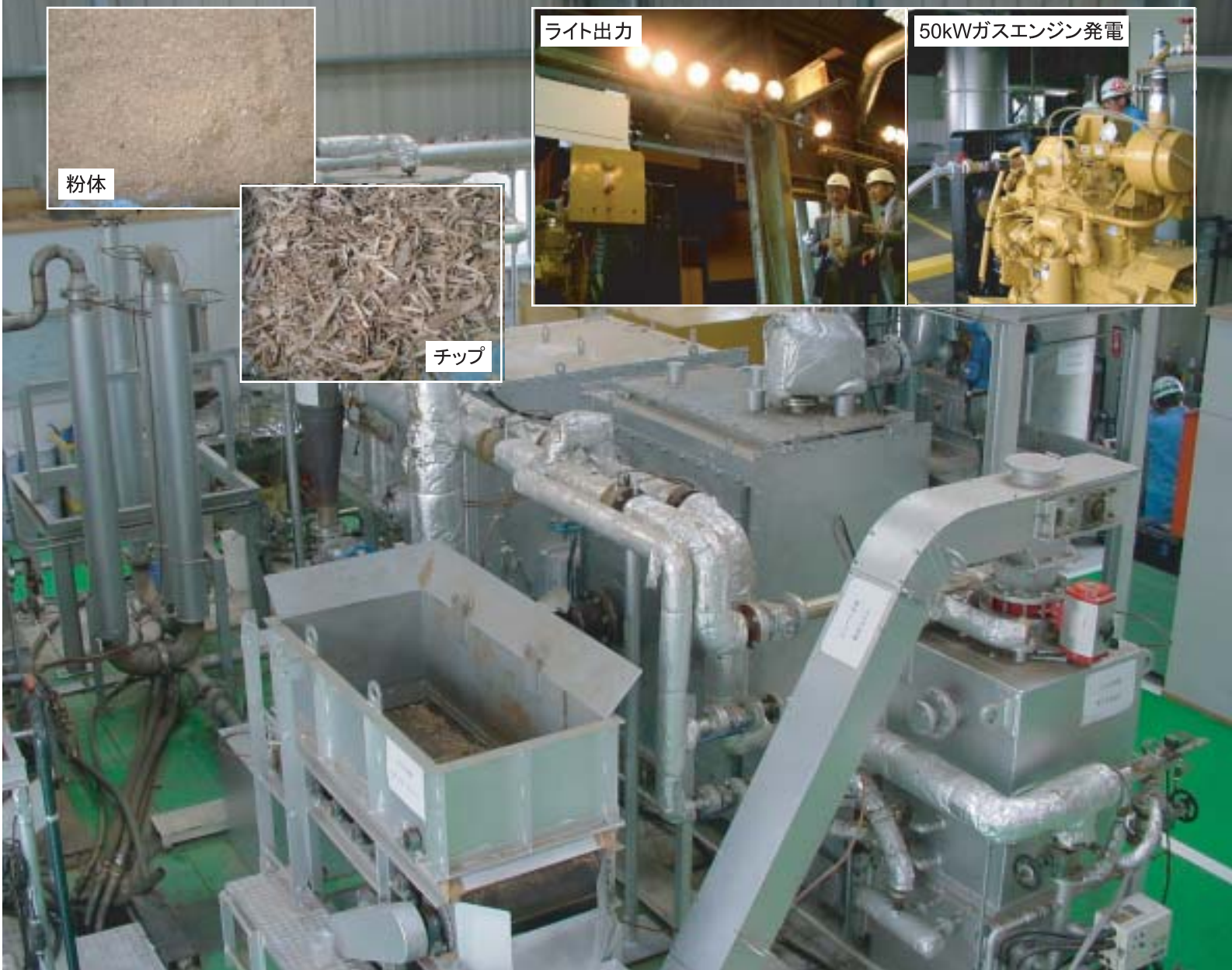
「農林バイオマス3号機」実証プラント全景
