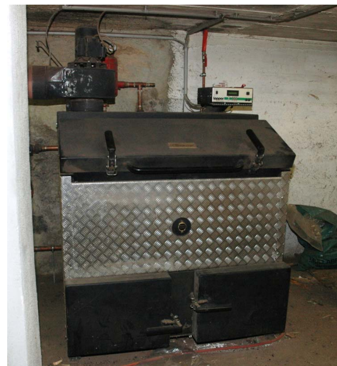
薪ボイラー（49kW）
