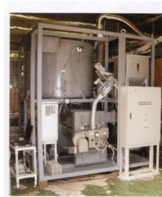
30RT 冷温水機外観
