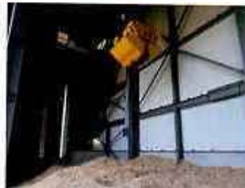
チップヤード&クレーン
