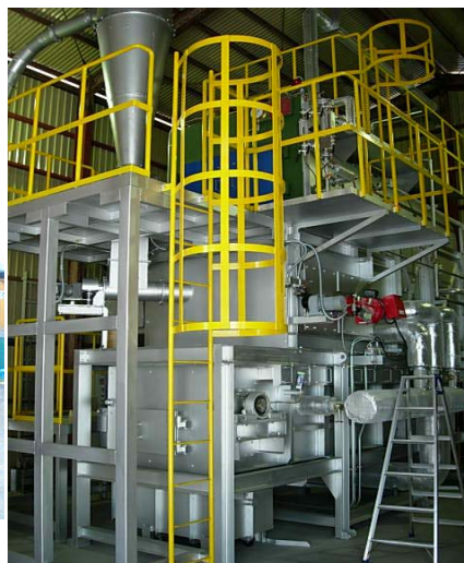
バイオマスボイラー
