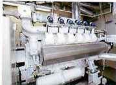
ガスエンジン
